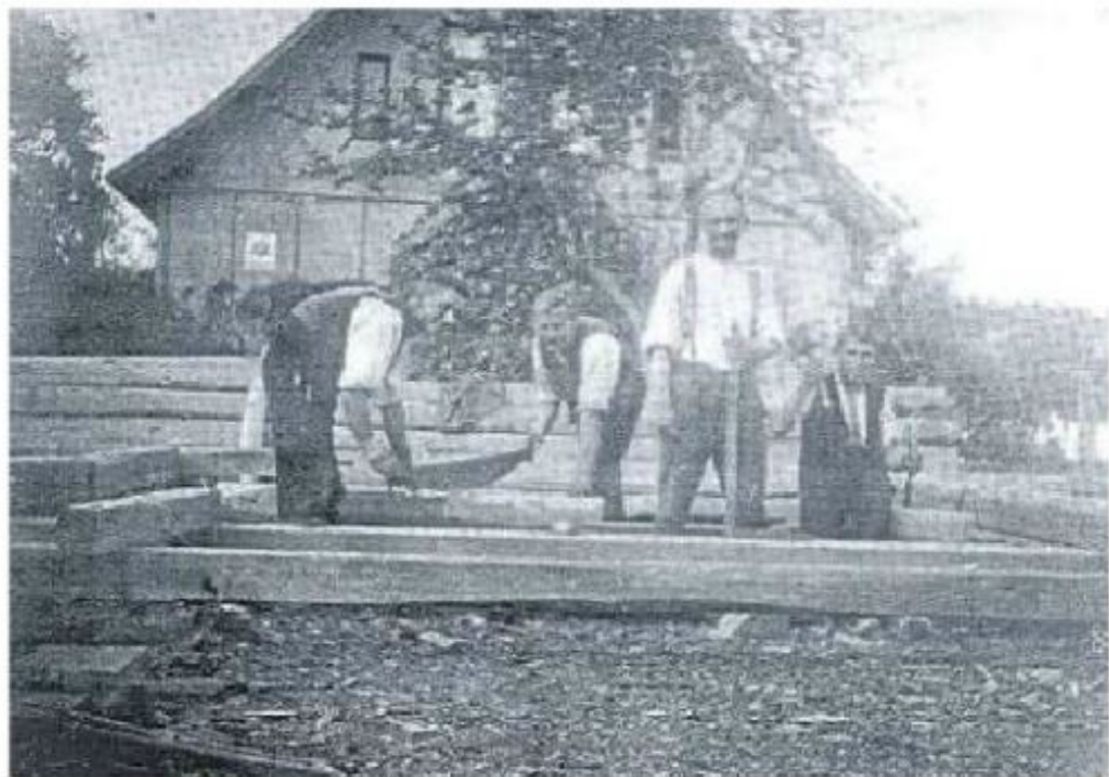
Auf dem Zimmerplatz der Holzbau-Firma August Dolle, Am Trockenkamp, sind im Jahre 1933 vier Zimmerleute bei Holzarbeiten tätig: Der aufrecht stehende Arbeiter mit dem großen Zimmermannswinkel ist Heinrich Hesterberg, der mit dem Bau der Brücke beauftragt wurde.
